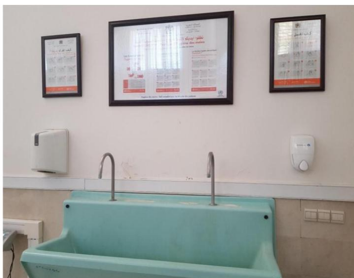
Figure 4 : Point de lavage des mains mis à niveau.
